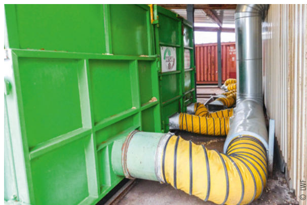
Kontejner za sušenje priključen na ventilacioni sistem
