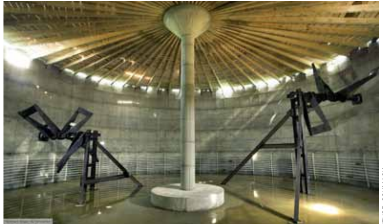
Unutrašnjost digestora pre puštanja u pogon
