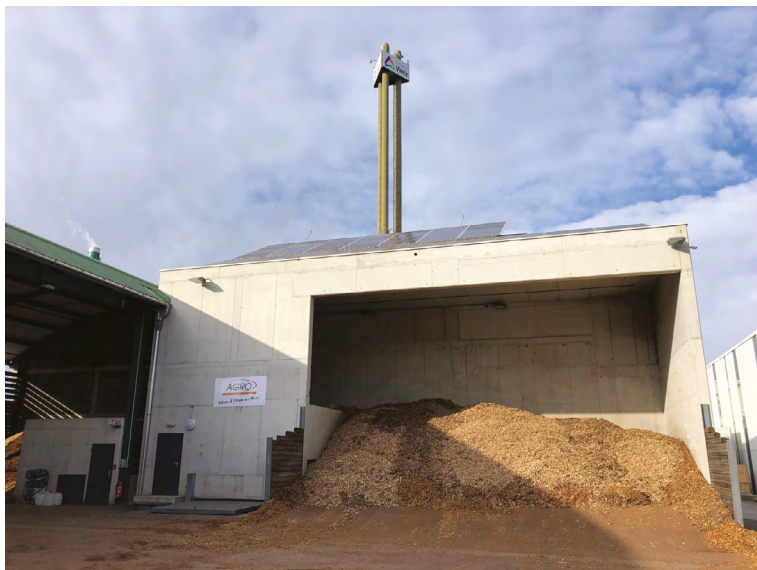
Slika 14: 8MW kotao Agro Forst - und Energietechnik, Weiz, Austrija
