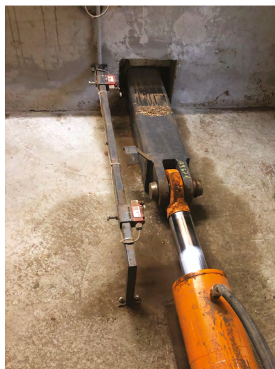
Slika 16: Hidraulični transporter sečke, 3MW kotao Agro Forst - und Energietechnik, Wolfstahl, Austrija, Foto: Foragrobio CC doo
