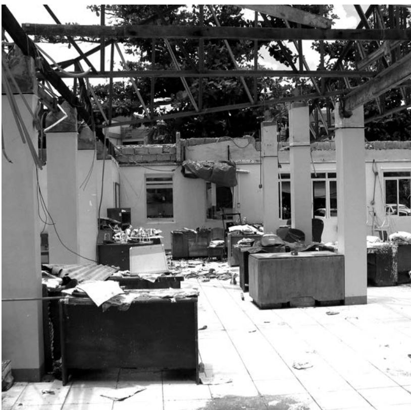
Uništena opštinska zgrada u gradu Ormok, Filipini
